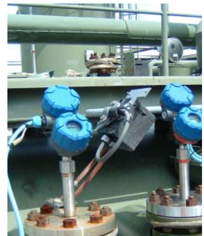
Kuva: Eclipse-sauvatutkat asennettuna vanhaan uimurimittauskammioon.
